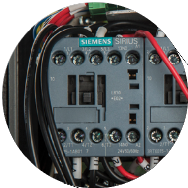
SIEMENS besturingssysteem / SIEMENS relais
